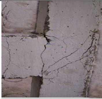
Fig. 8(a) Failure pattern of CS-T
